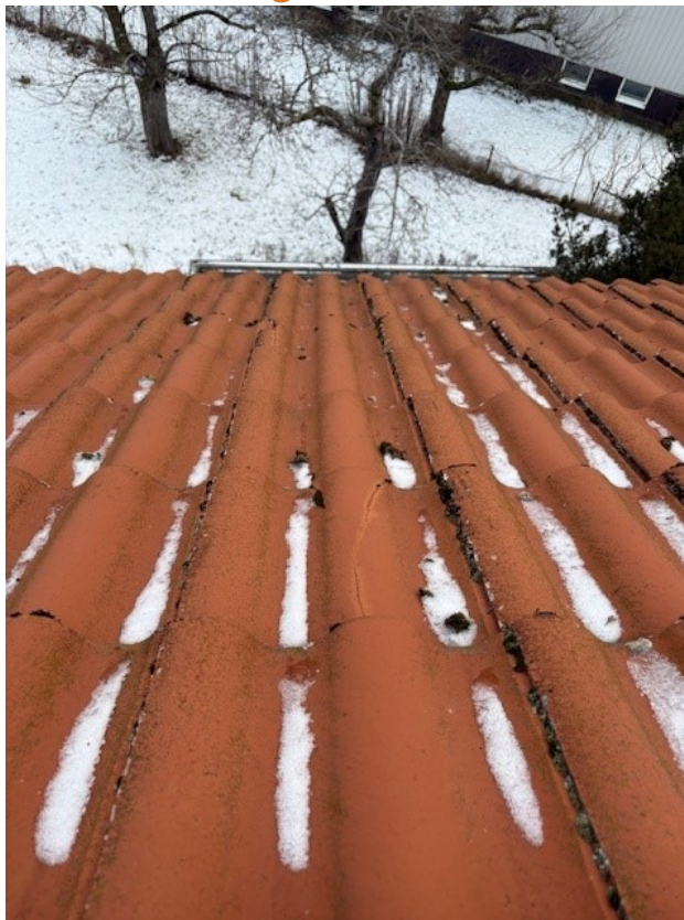
Synliga sprickor i ett par takpannor via takluckan.
